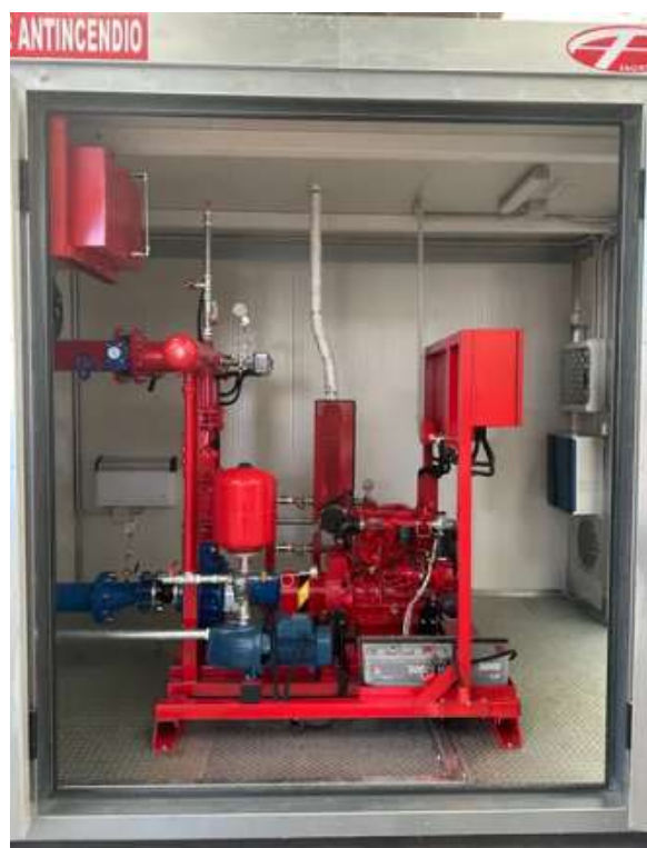
locale tecnico UNI 11292:2019
